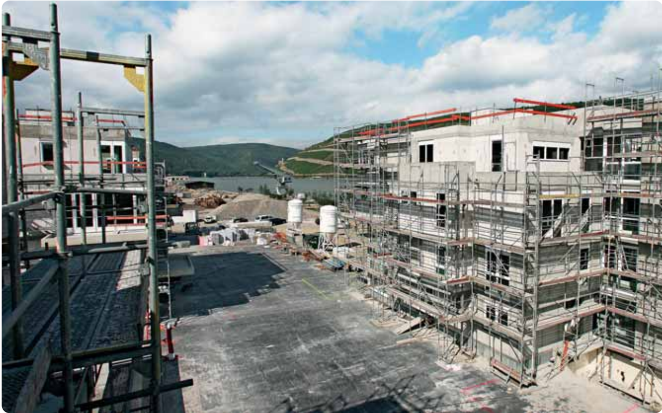
Das neue „Fußballfeld“ am Rhein: Die Binger Baustelle ist fein säuberlich aufgeräumt
