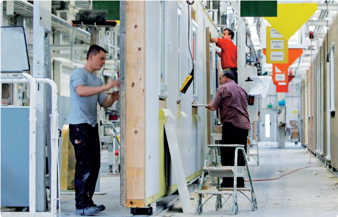
Immer an der Wand lang: Sind Fenster und Türen eingebaut, geht es zügig auf die Baustelle
